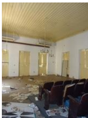
Interior da Biblioteca Municipal de Cáceres/MT – fechada para reforma, onde hoje é ponto de uso de entorpecentes
