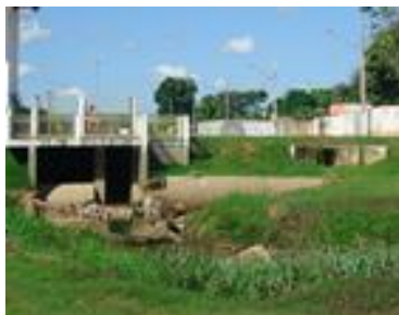
Esgoto que desemboca as margens do Rio Paraguai, centro de Cáceres/MT
